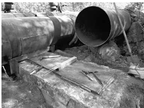
Рис. 2. Результат ликвидации локального коррозионного повреждения путем установки заплаты на подающем трубопроводе диаметром 800 мм
