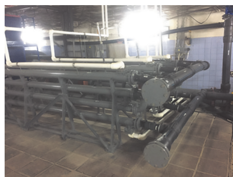
Рис. 11. Внешний вид теплообменника на высоковольтной КНС
