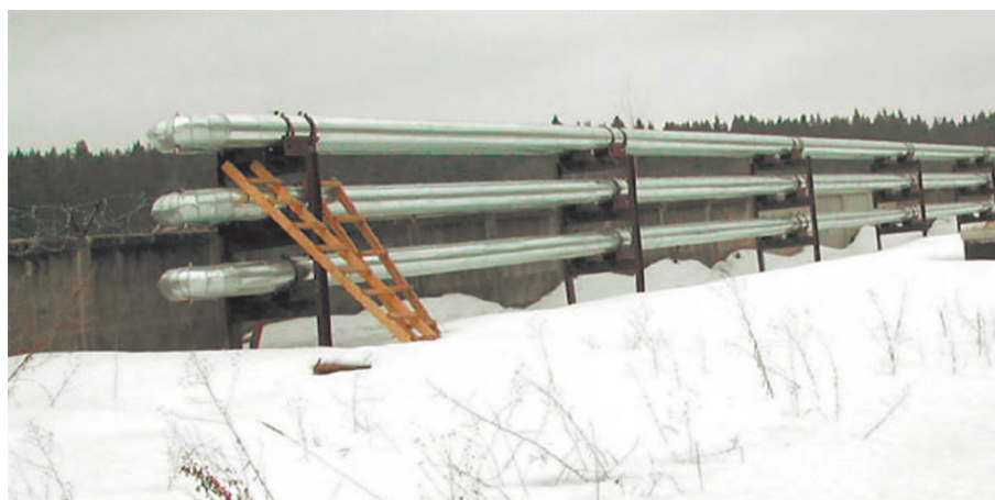
Рис. 13. Внешний вид теплообменника-утилизатора, установленного на улице
