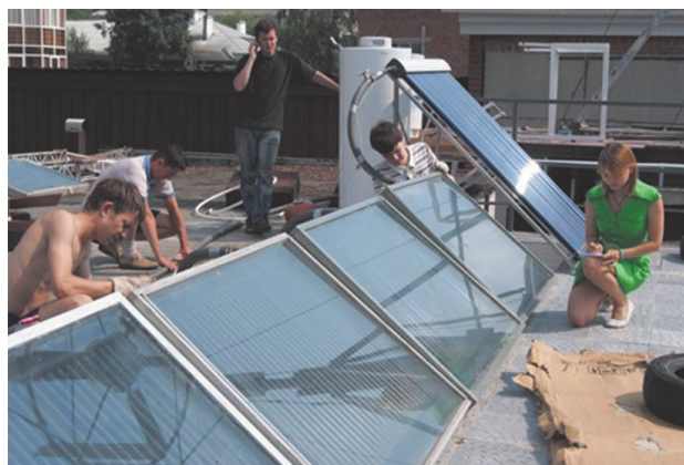
Рис. 3. Гибридная теплогенерирующая установка
